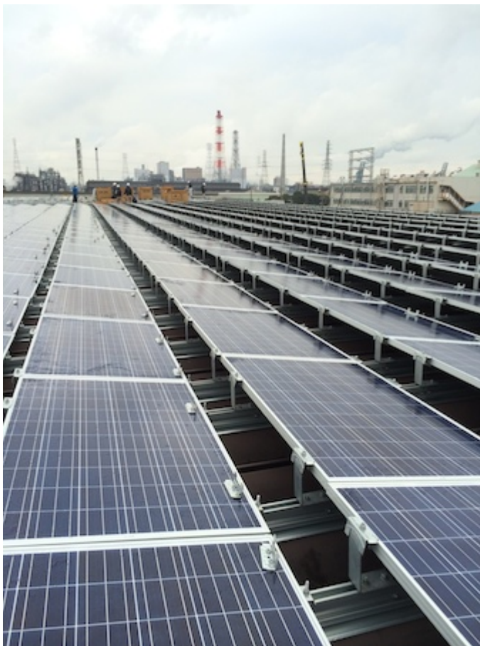
工場の屋根の太陽光パネル (横浜市)
