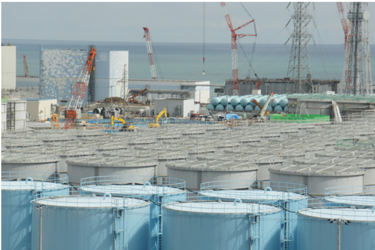
(写真1) 福島原発遠景。左の青い建屋は2号機、右が3、4号機。そして大量の処理水タンク
