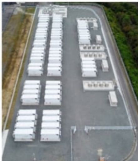
「紀の川蓄電所」全景
