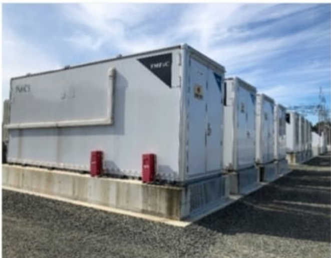
蓄電池コンテナ
