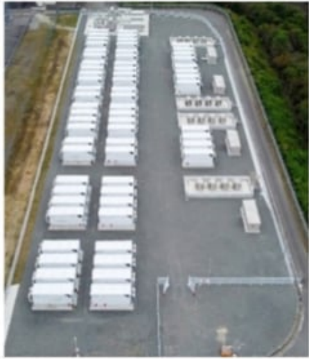
「紀の川蓄電所」全景
