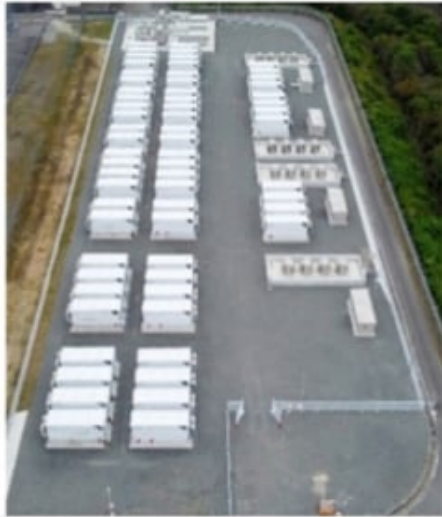
「紀の川蓄電所」全景
