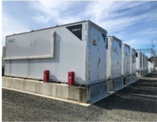
蓄電池コンテナ
