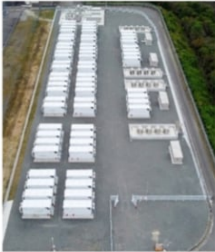
「紀の川蓄電所」全景
