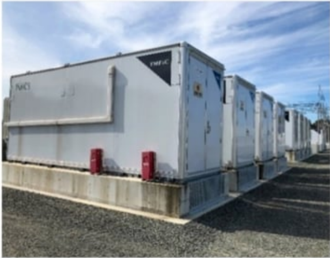
蓄電池コンテナ
