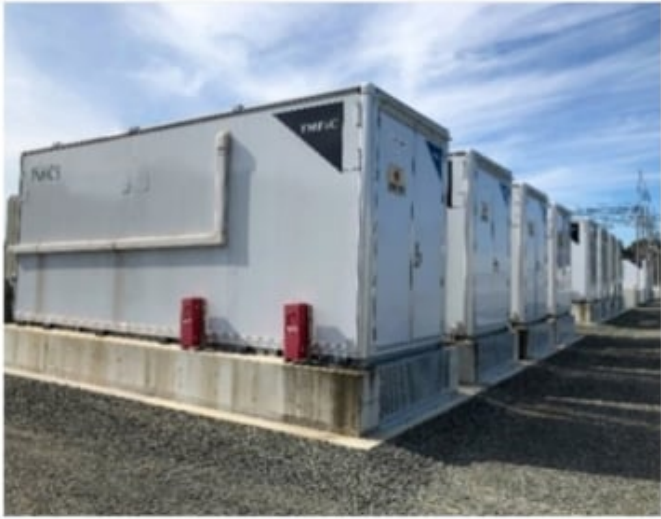
蓄電池コンテナ
