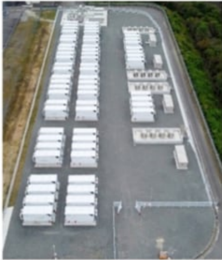
「紀の川蓄電所」全景
