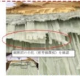
図-2 ブレード中間折損部の破断面
